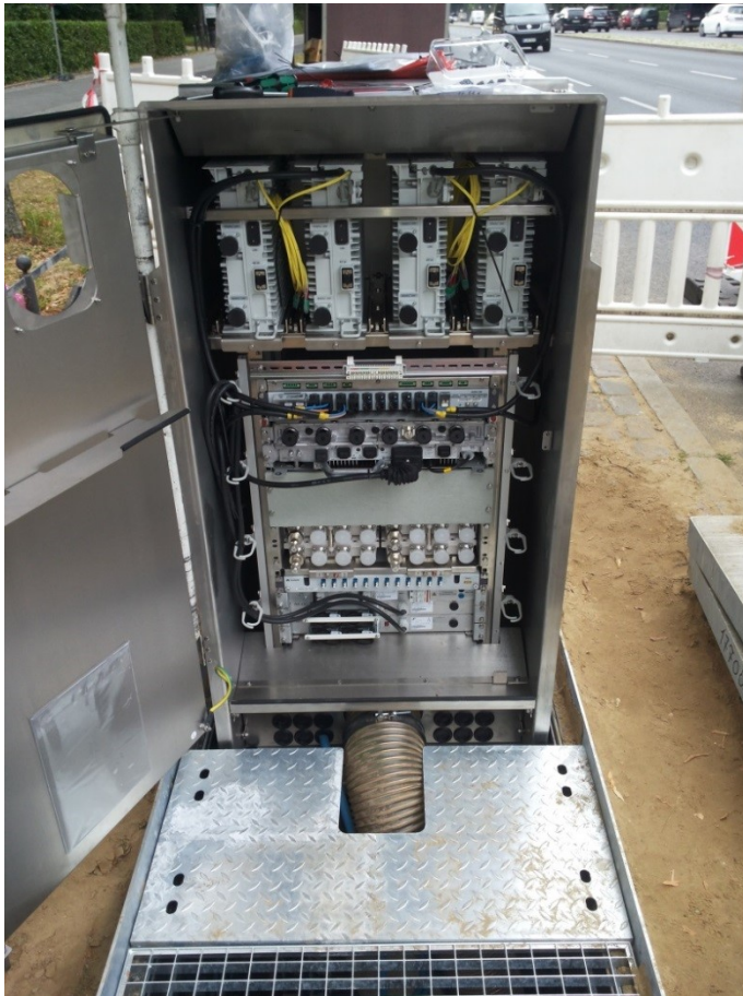
LTE / UMTS Basisstation mit Antennenmischer & Stromversorgung
