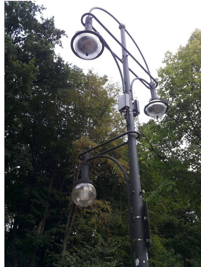
LTE / Antenne an der Straßenlaterne
