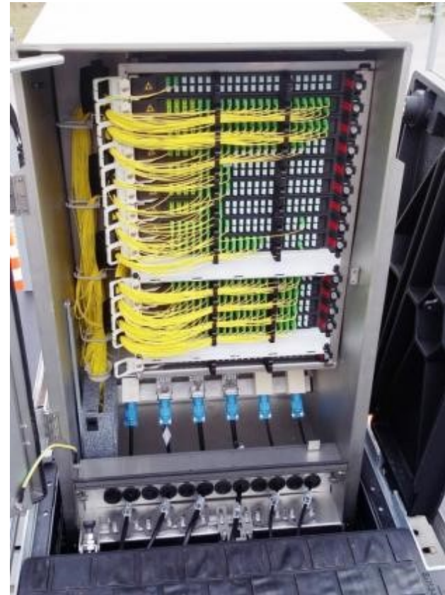
Glasfaser Patchverteiler / Muffenersatz
