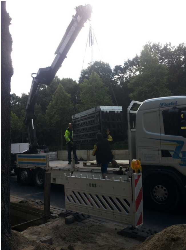
Unterflurverteiler: UMTS / LTE Basisstation Berlin - Fanmeile
